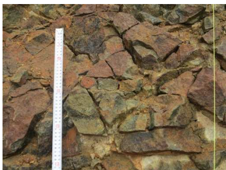
図-6 TR-20'-2 拡幅部の安山岩。岩石の割れ目が最大 2-3 cm 程度開口している。
