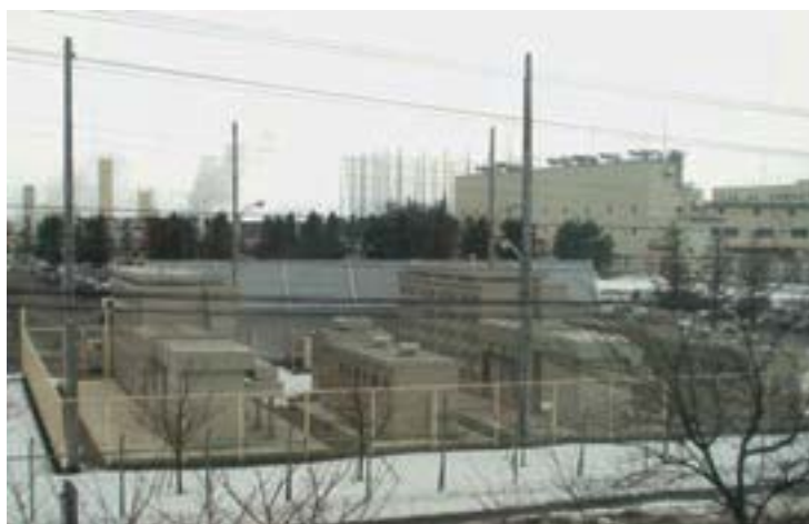
東北エネルギーサービス(株)が受注した 瞬時電圧低下補償機能付 NAS 電池システム (会津若松市・富士通(株)会津若松工場様)
