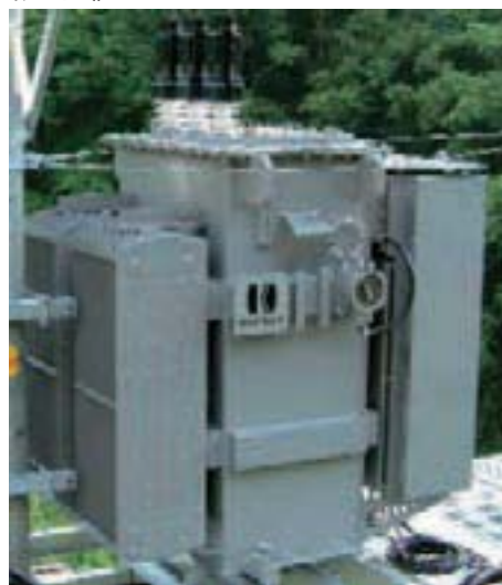
開発した磁束制御型電圧変動抑制装置
