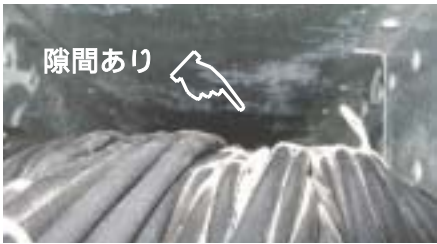
ケーブル処理室より下層階（床貫通） （シール不適切箇所例）
