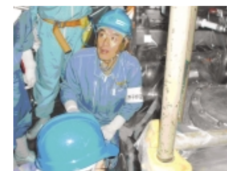
主要弁の漏えいを確認している様子
