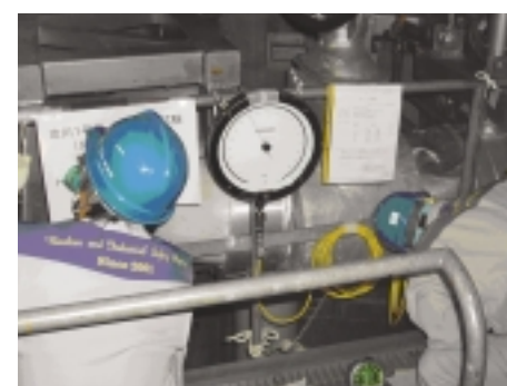
主要弁の漏えいを確認している様子
