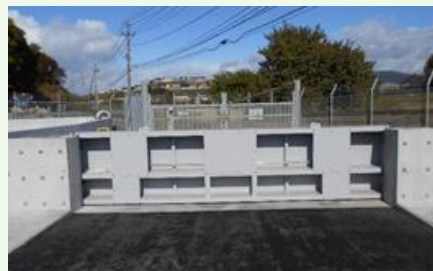
浸水対策として、変電所に防水ゲート、防水壁を設置
