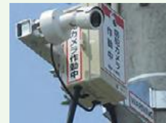
電柱設置型防犯カメラ
