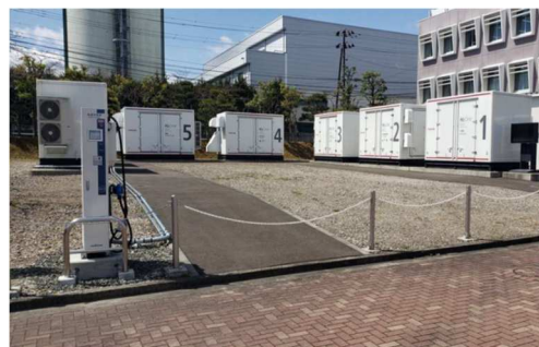
水素製造システム
