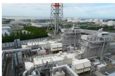
新潟火力発電所 5号系列
