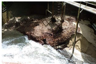
写真1 水槽土砂堆積状況（現状）
