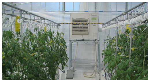
図2 ヒートポンプ室内機のハウス内設置状況
