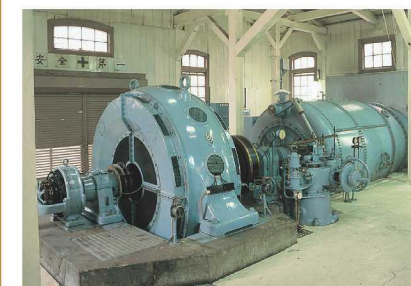
発電所関係機器
