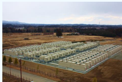
2月に運転を開始した南相馬変電所蓄電池 システム。蓄電池技術を活用した再エネの 導入拡大に取り組んでいる。
