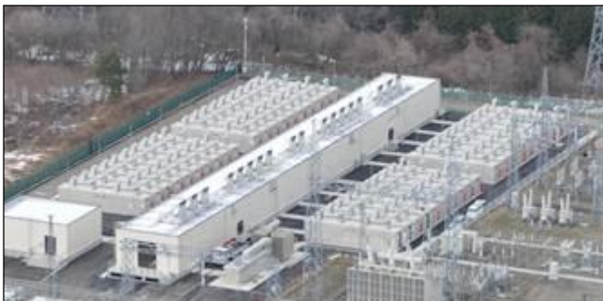
【写真：西仙台変電所蓄電池システム外観】
