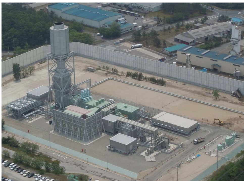
5 号機発電設備の全景
