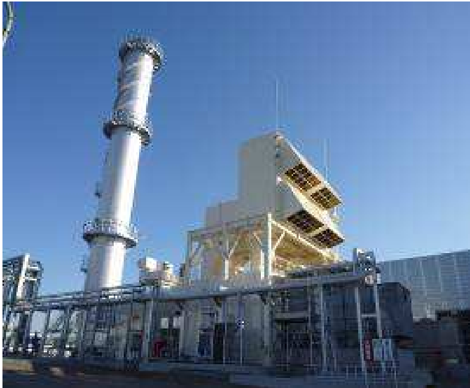
6 号機発電設備の全景
