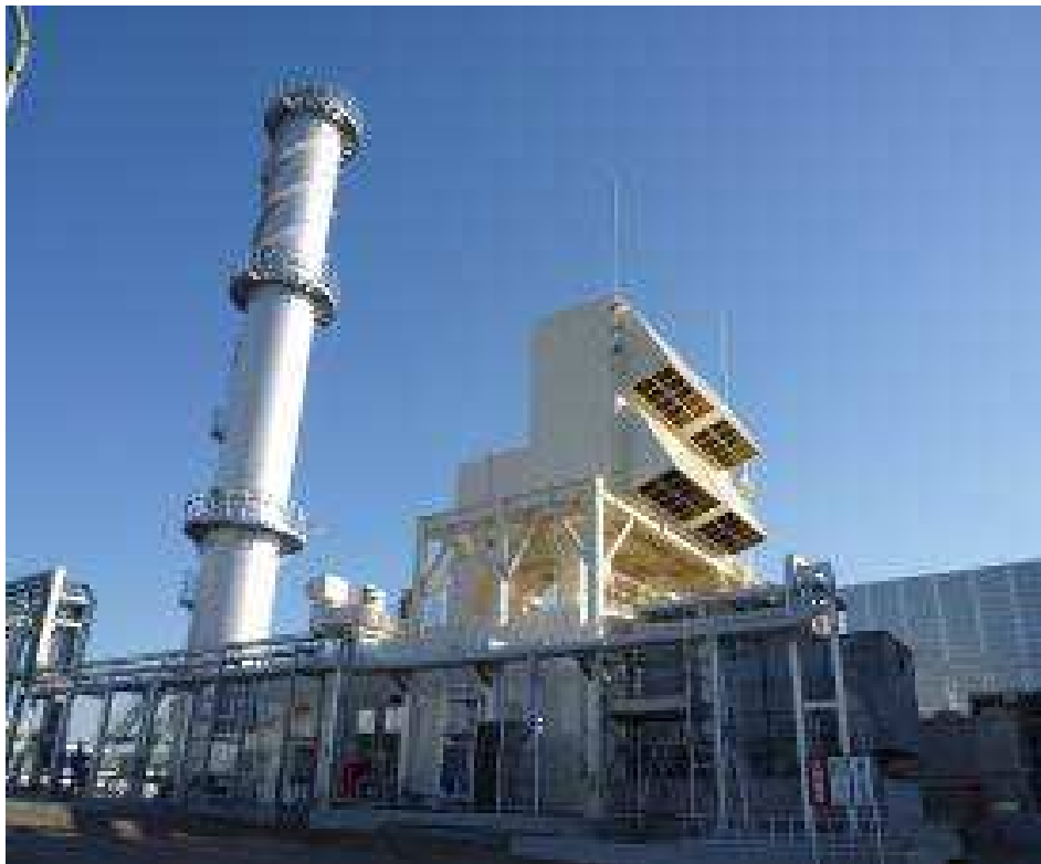
6 号機発電設備の全景
