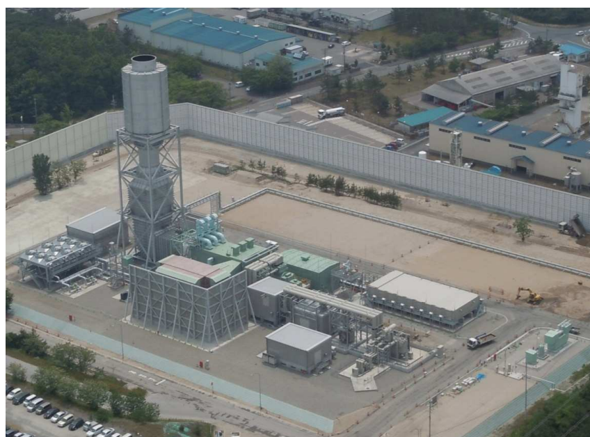
5 号機発電設備の全景
