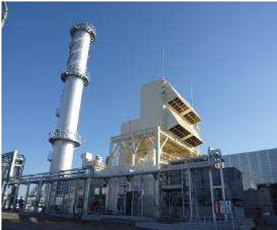
6 号機発電設備の全景
