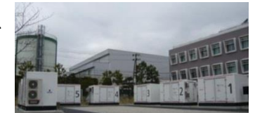
⑥ 水素製造システム（東北電力研究開発センター）
