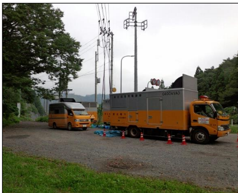
高圧発電機車による送電の様子
