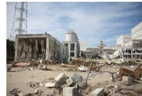
[原町火力発電所]
