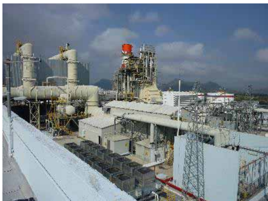
サルティージョ発電所
