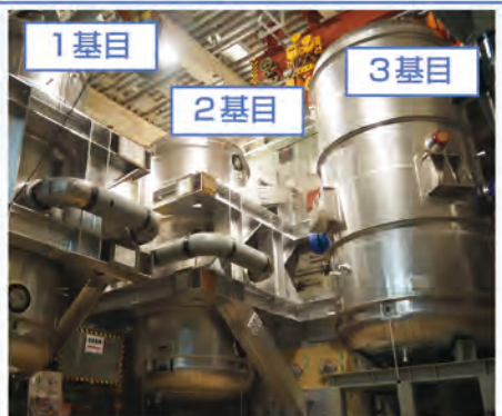
3 2019年2月21日に3基目が、2号機原子炉建屋に搬入された。今後は、配管の設置工事を実施していく。
