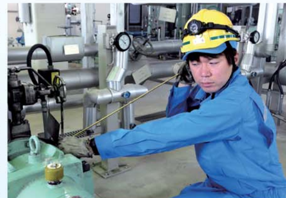
設備からの異音の有無や計器指示値のチェック等、運転状況に異常がないかを定期的に確認
