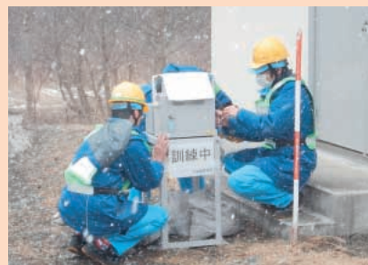
発電所構内に可搬型モニタリングポストを設置し、放射線量のデータを収集する様子
