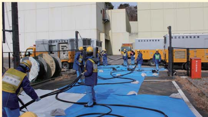
電源車を用いた電源確保訓練の様子
