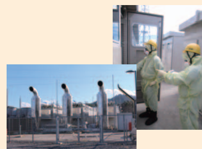
大容量電源装置を用いた電源確保。(起動訓練)
