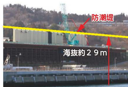
港湾から見た防潮堤の設置状況 (茶色の鉄骨材はクレーン作業台)
