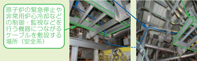
非安全系の「タービンの制御などのその他ケーブル」が複数の場所にまたいで敷設されている状態
