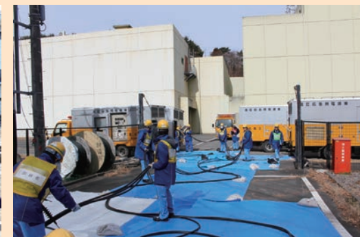
電源車を用いた電源確保訓練の様子
