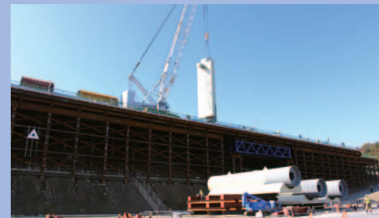
大型クレーンで上杭を吊り上げる（写真の鋼管杭（上杭）は直径2.2m、長さ13.5m、重さ約24t）
