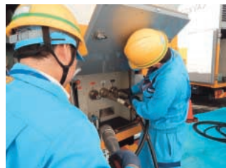
原子炉建屋に電気を送るための電源車の接続訓練
