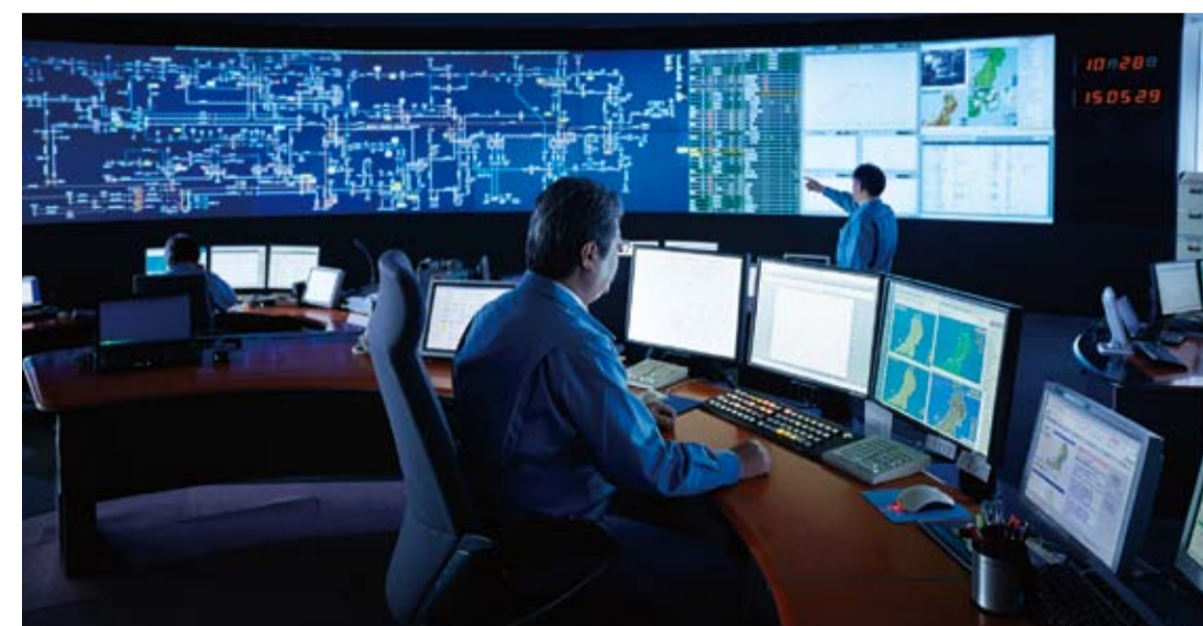
24時間365日、発電所や変電所、送電線などの電力システムを監視・制御する「中央給電指令所」
