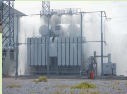
変圧器水噴霧消火装置による消火活動 噴霧前(左) 噴霧後(右)
