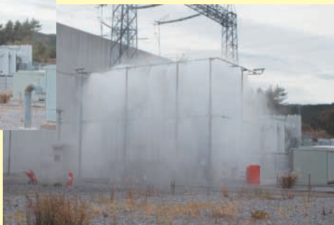
変圧器水噴霧消火装置による消火活動 噴霧前(左) 噴霧後(右)
