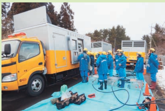
電源車の移動および起動、受電の操作
