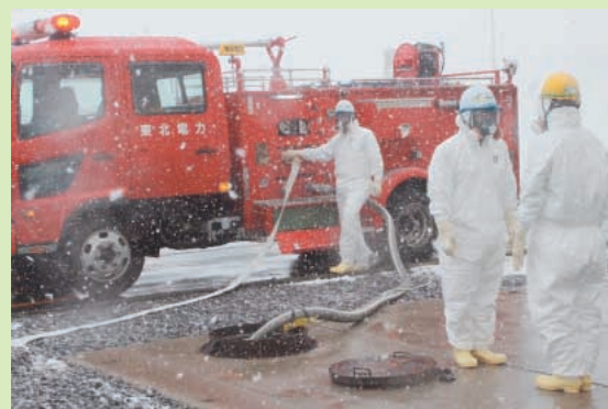
防火水槽から取水し原子炉等へ注水
