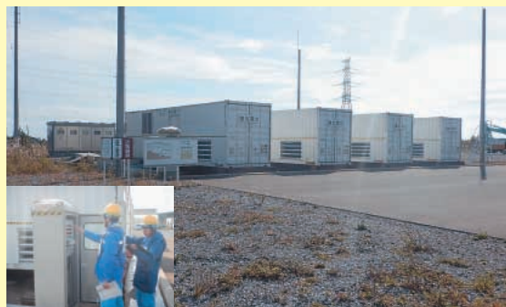
大容量電源装置による「電源確保訓練」
