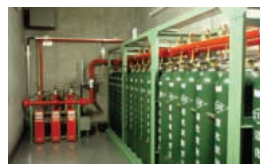
自動消火設備
