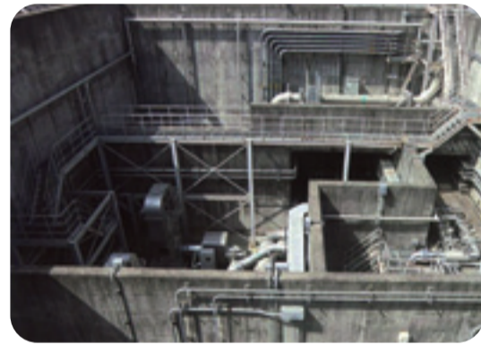
▲深さ12mのくぼみに設置した海水ポンプ
