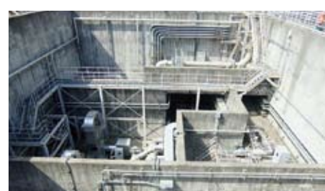
▲海水ポンプなどが設置されている立坑(ピット)
