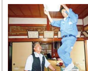
高齢者宅電気設備点検訪問
