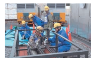
電源確保訓練(発電所内)
