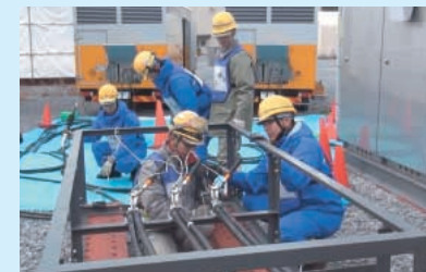
電源確保訓練(発電所内)
