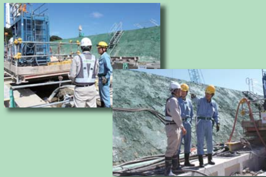
▶ 防潮堤の建屋側では地盤改良材を注入する作業が進ちよく中
