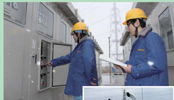
大容量電源装置の 起動訓練
