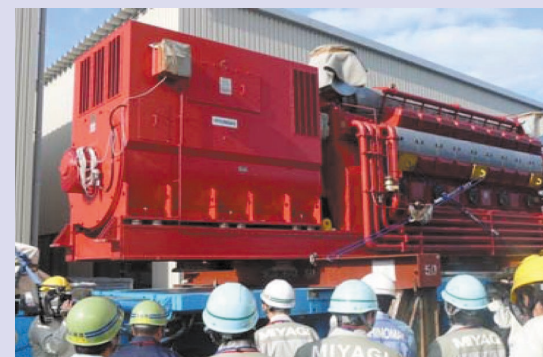
▲緊急時に電源を確保するための大容量電源装置。平成23年度末までに配備完了予定
