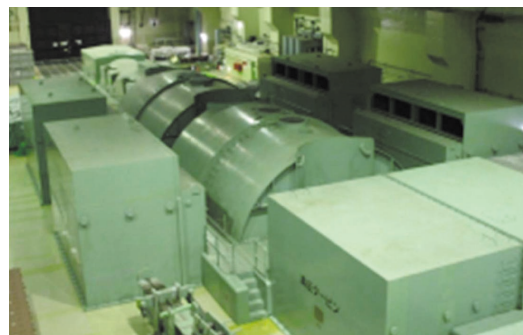
▲ 1号機タービンの外観。外観点検では顕著な損傷は確認されませんでした
