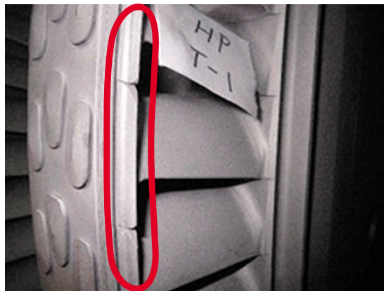
▲ 動翼と静翼には接触跡などが確認されました（写真は2号機の動翼側）。今後、詳細な点検や補修を行います
