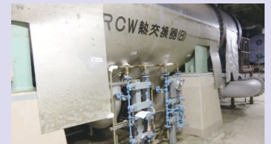
▲海水ポンプ室の水位計設置箱から流入した海水で浸水した2号機の補機冷却水系熱交換器室。海水の流入防止策として、水位計設置箱を取り外し、開口部に閉止板を設置しました
