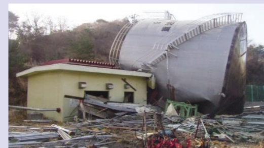
▲発電所敷地より低い港湾部に設置された1号機の重油貯蔵タンクは津波により倒壊。オイルフェンスを設置して港湾への重油の流出拡大防止を図っています
