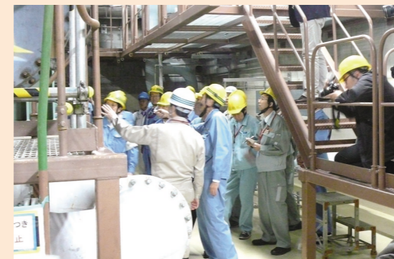
▲浸水した2号機の熱交換器室などの設備被害状況を確認いただきました
