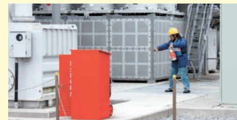
初期消火にあたる発電所員
