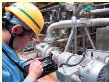
機器の状態監視の様子(振動診断)
