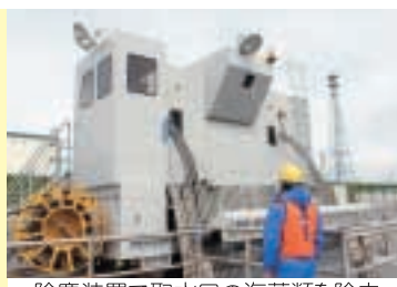
除塵装置で取水口の海藻類を除去
