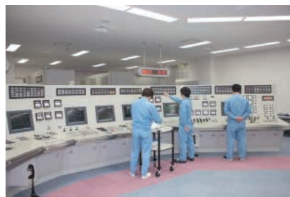
3交代、24時間体制で運転・監視を行います
