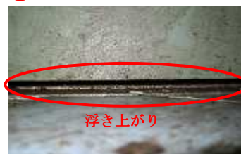
中間軸受箱 修繕前
